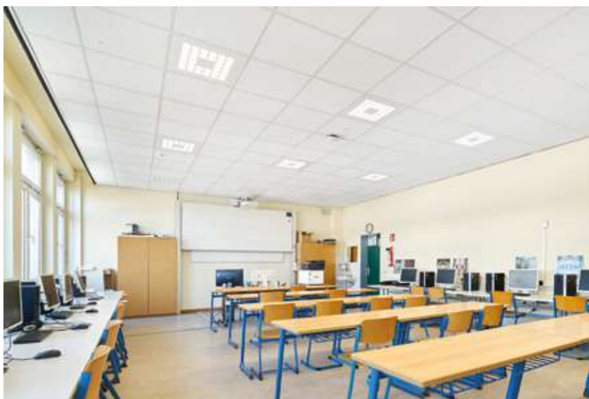
Abb. 2.13: Flächige, akustisch wirksame Systemdecke mit Einlegeleuchten.
